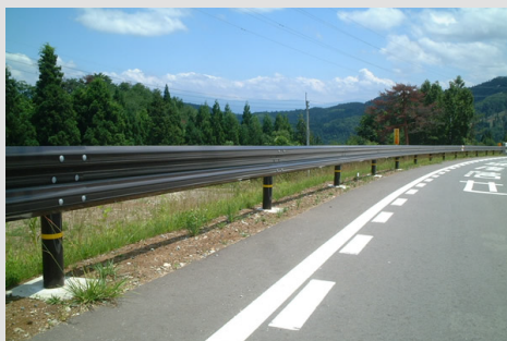
ガードレール
