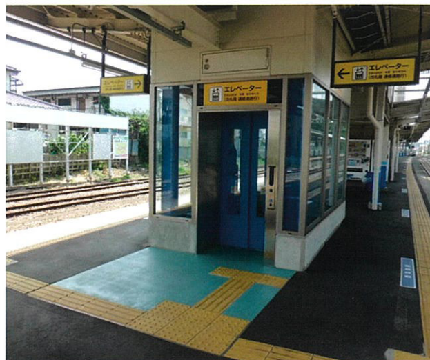
■ 松戸市某エレベーター 【施工年月：平成 22 年 11 月】
