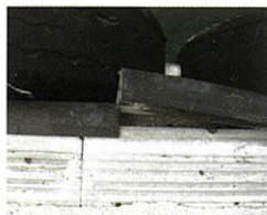
保護用ラバー破損状況
