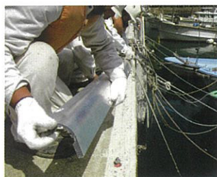
本体設置状況
