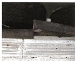
保護用ラバー破損状況
