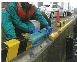
本体設置状況
